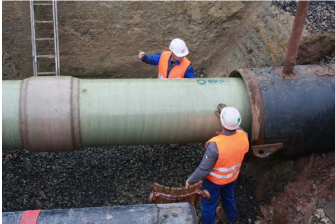
Mantelrohr DN 1200 (schwarz), GFK-ummanteltes Stahlrohr (grün) mit GFK-Gleitkufe (bräunlich)
