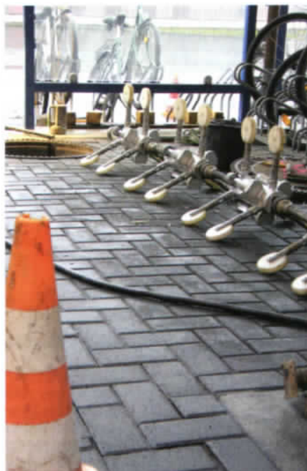
Lichtquelle kurz vor Einzug in den Liner.
