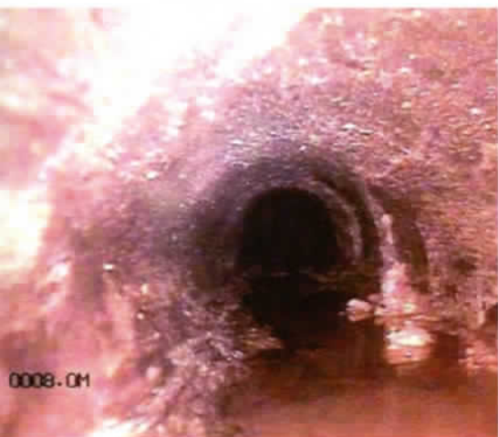
Zustand des Altrohrs vor der Sanierung: deutliche Ablagerungen
