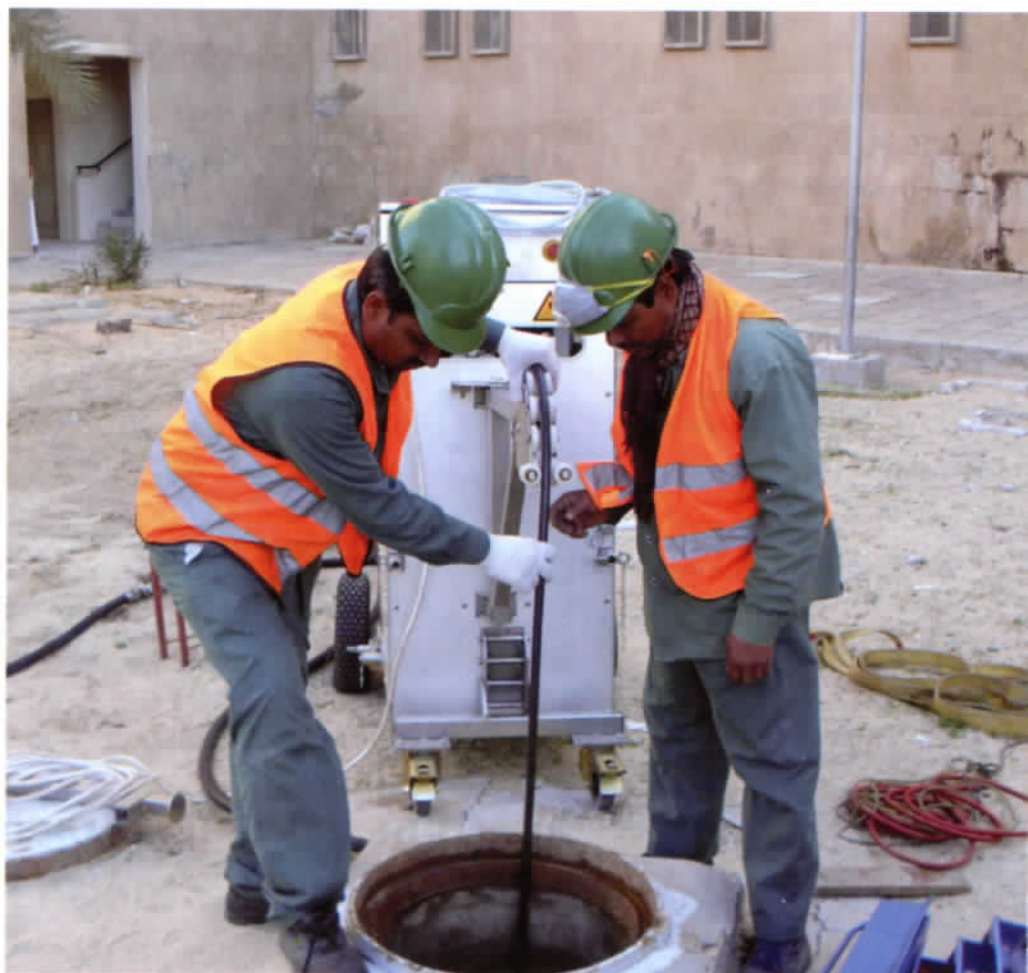
Von der mobilen Aushärteanlage ausgehend wird die Lichtquelle samt Kamera in den Liner gegeben.
